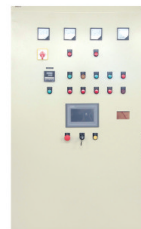
消防巡检柜门板
