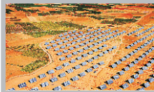
太阳能发电站 Solar power station
